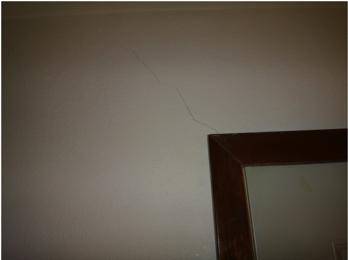
Door Wall Crack
